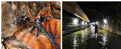
暗挖隧道湧水
