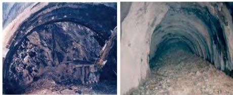
隧道開挖破碎帶抽坍
