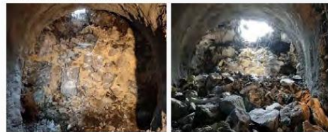
隧道開挖崩積層抽坍
