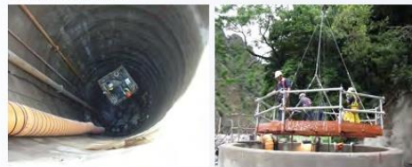
TBM 隧道湧水
