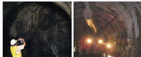
隧道開挖溫泉突湧封堵
